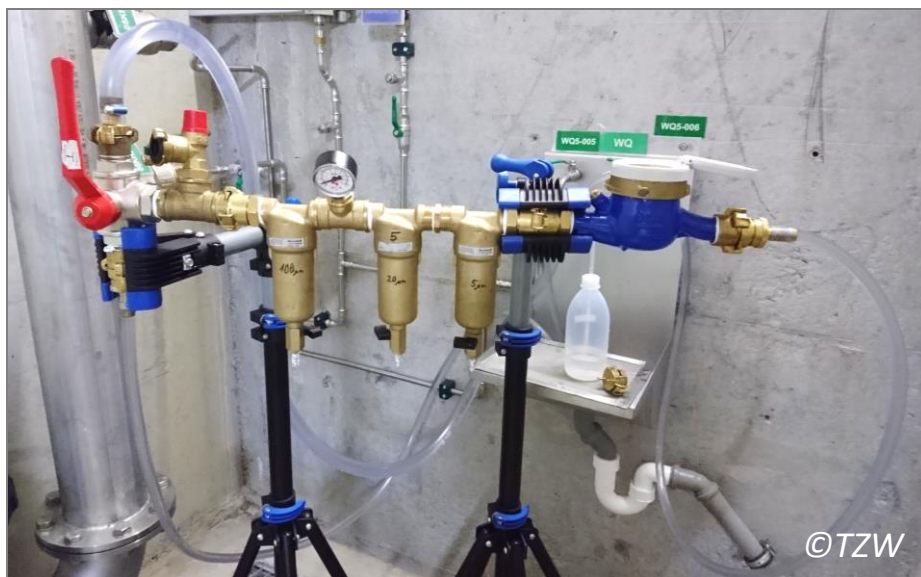
Abbildung 1: Probenahme im Hochbehälter Steppach.
